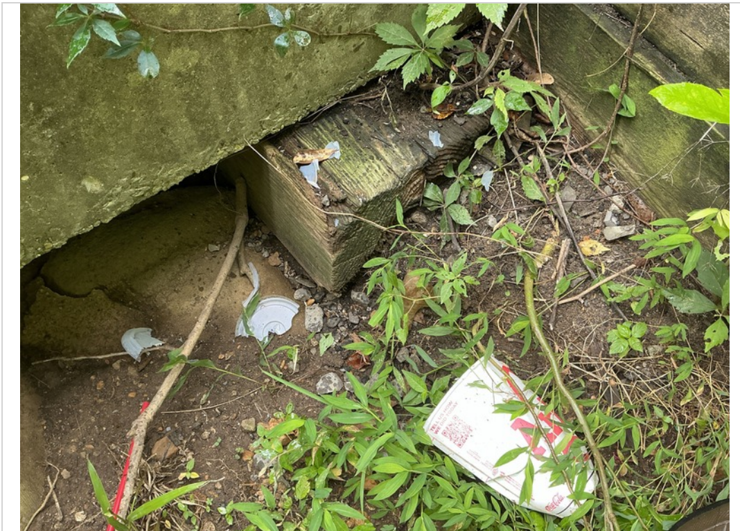
ABT 1 Cap LT Decay
